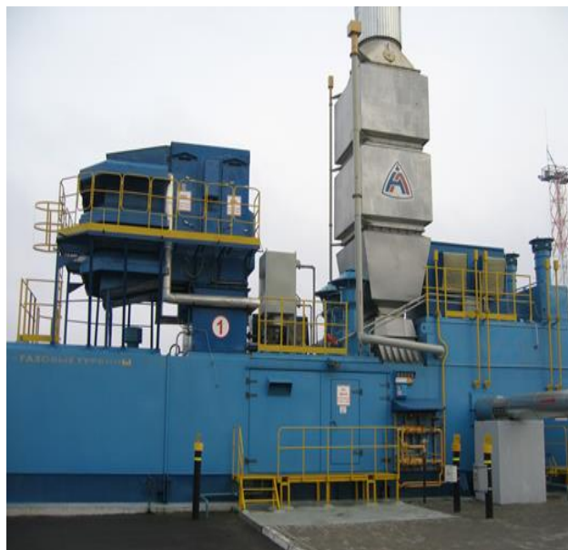
Рис. 13.12. Газо-компрессорная станция в Краснознаменском районе
