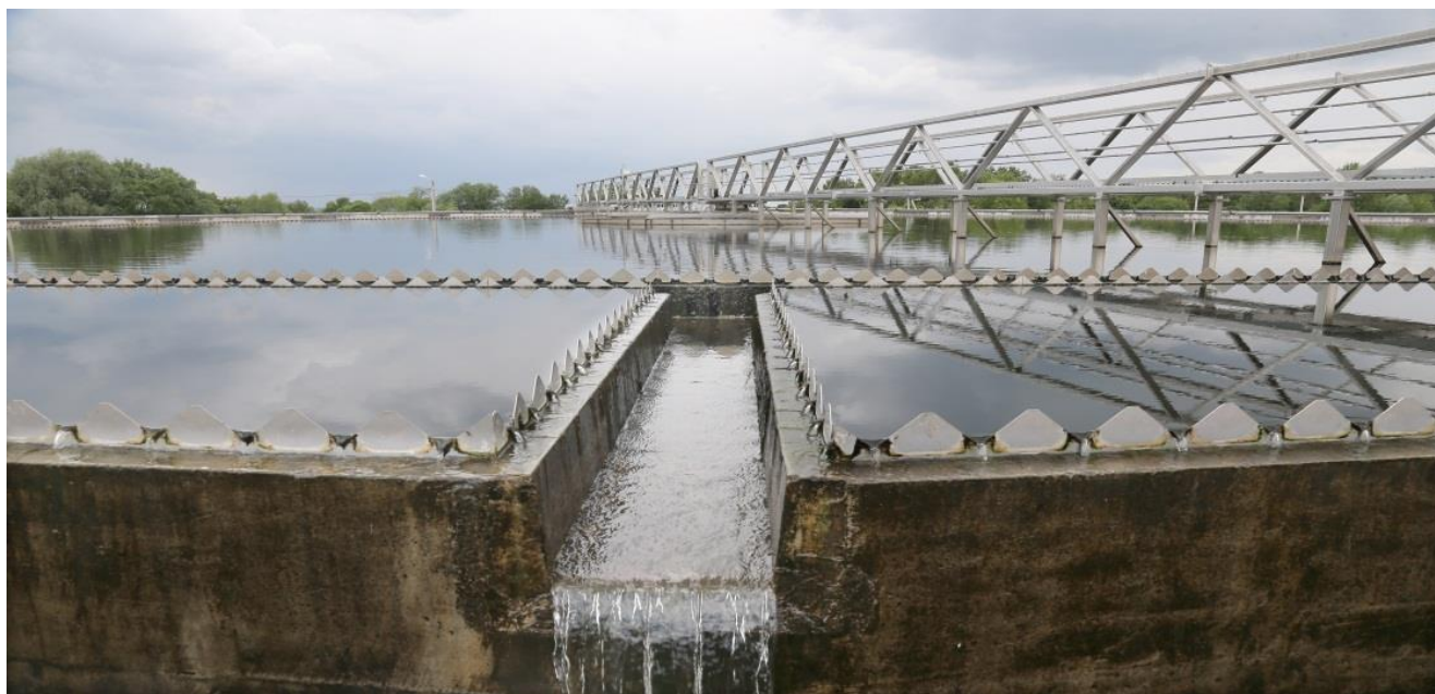
Рис. 3.24. Очистные сооружения г. Калининград
