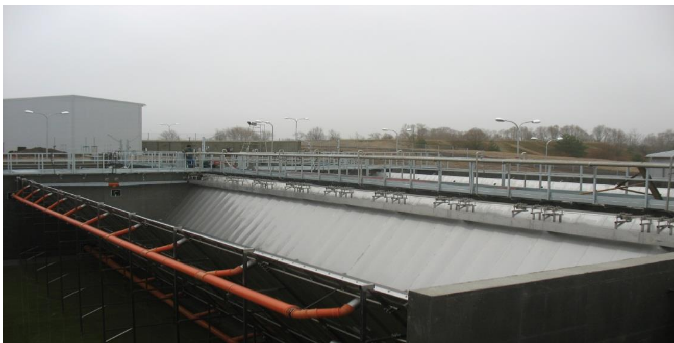
Рис. 3.25. Очистные сооружения в городе Немане
